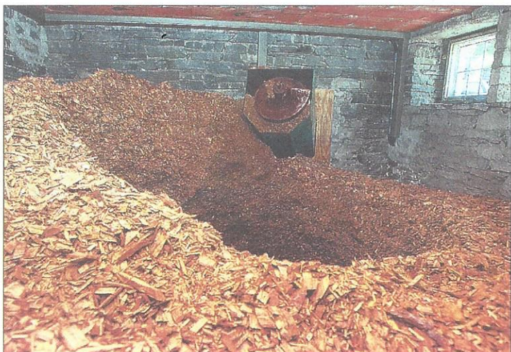
Il riscaldamento a trucioli di legno è il nucleo centrale dell'albergo. Richieste per poterlo visitare arrivano sempre da scuole e da privati.
